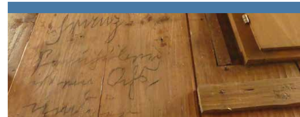
Durch übermäßige Grundfeuchtigkeit war das Kirchenportal stark angegriffen.
