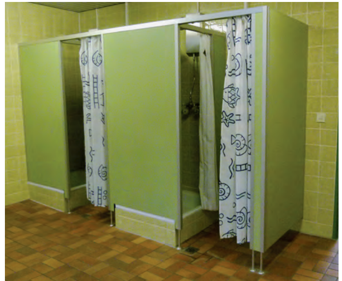
Der Sanitärbereich mit den Duschen
